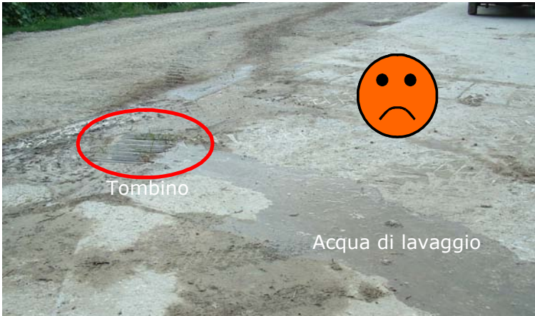
Fig. 103 - Acque di lavaggio immerse direttamente nella rete fognaria
